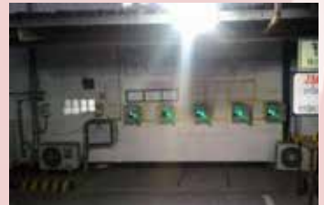
Solar Moon Light 8W กลดลงติดตั้งที่บ้านงาน
