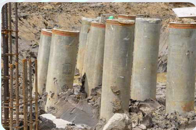
ภาพที่ 2 แสดงการเยื้องศูนย์ของเสาเข็มตามแนวตั้ง (Vertical Deviation)
