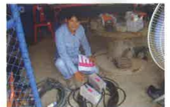
การตรวจสอบประจำเดือน โดยช่างไฟฟ้า และติดสติ๊กเกอร์รับรองการตรวจสอบ
