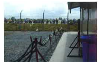
การจัดวางสายไฟฟ้า ไม่ให้กีดขวางทางเดิน
