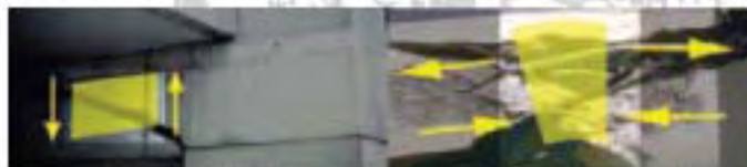
การแตกร้าวที่มีผลต่อพฤติกรรมของโครงสร้าง
