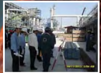
การจัดการและจัดเก็บวัสดุ/อุปกรณ์บริเวณหน้างาน
