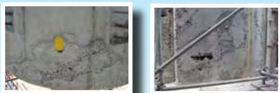
รูปแสดงการเกิดโพรงและโพรงแบบรังผึ้งที่คอนกรีตโครงสร้าง
